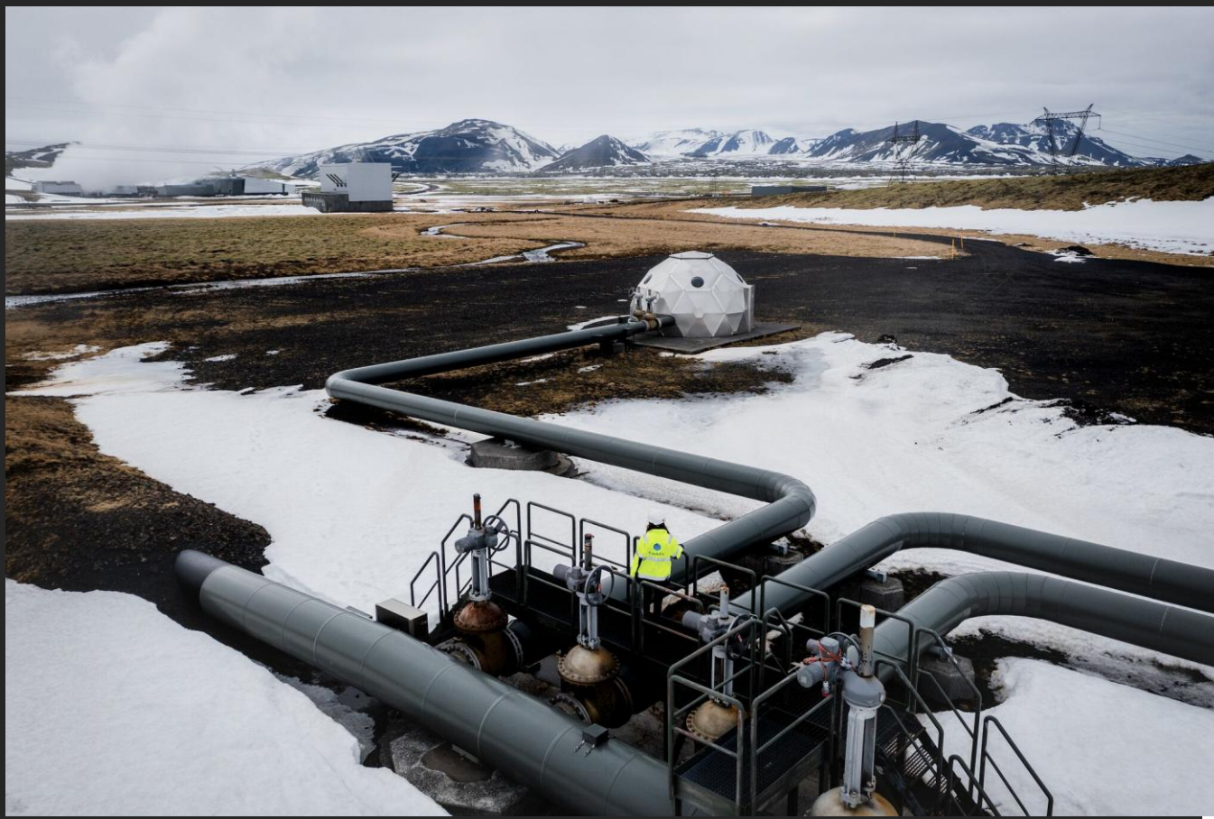
Point d'injection de Carbfix près de Hellisheiði, photo Carbfix
